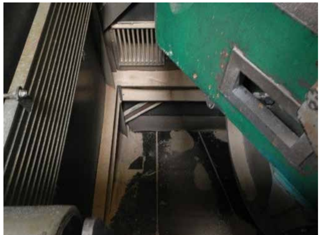
d) Blick vom Zugang in die Einhausung der Blockbandsäge auf die Erfassungsstelle (Gitter) und die Späne-Rutsche.
