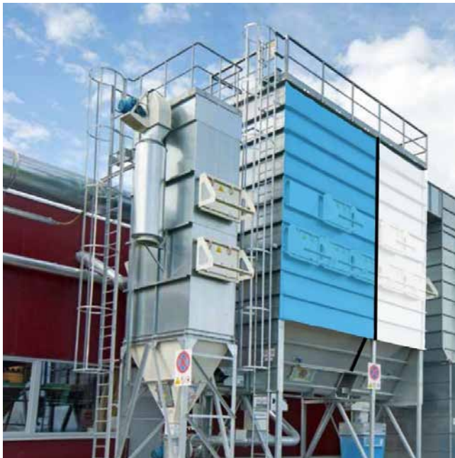
Abb. 70 Holzstaub-Absauganlage mit separaten Abscheidern für Aluminium- (links) und Kunststoffabfälle (rechts)
