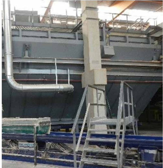
b) Verlauf der Anschlussrohrleitung (links) von der auf dem Hallendach positionierten Filteranlage zur Absaugung der Blockbandsäge im Bereich der Späne-Entsorgung unterhalb der Sägeebene
