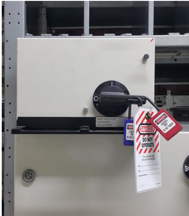
Abb. 10 Sicherung des Hauptschalters mit Vorhängeschloss und Warnhinweis
