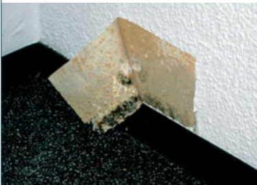
Bild 3: Schimmelpilzbefall unter der Tapete
