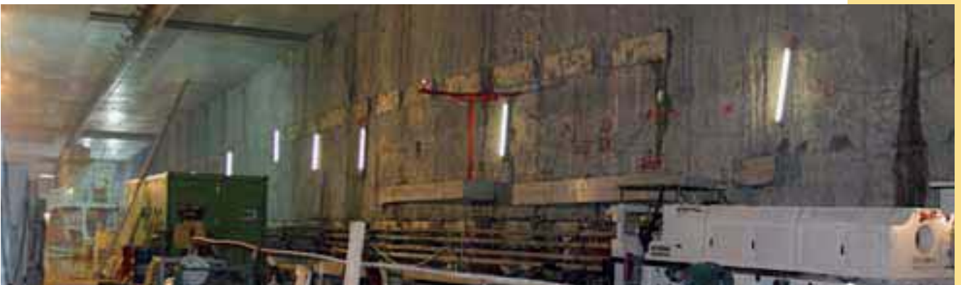
Leuchten wegen geringerer Verstaubung und besserer Wegbeleuchtung senkrecht angebracht
