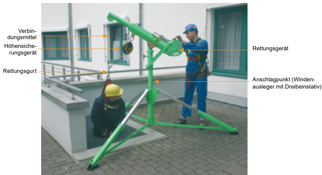
Abbildung 5: Beispiel für ein Rettungssystem mit Höhensicherungsgerät als Zweitsicherung
