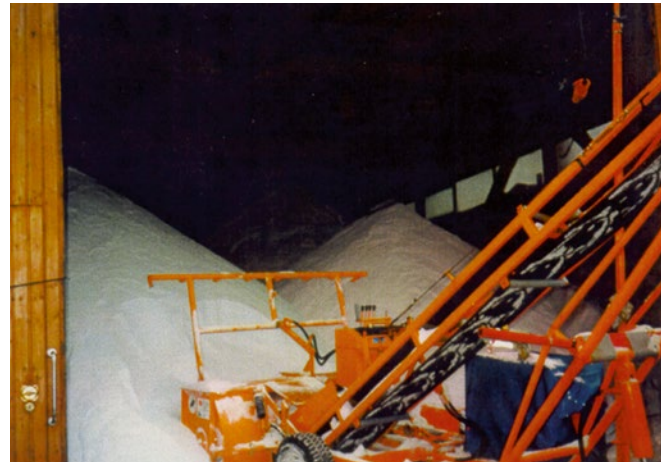
Abb.9 Streuguthalle mit Salzladeförderbandt
