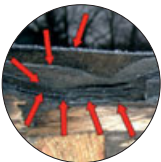
Teerhaltige Dachpappen: PAK
