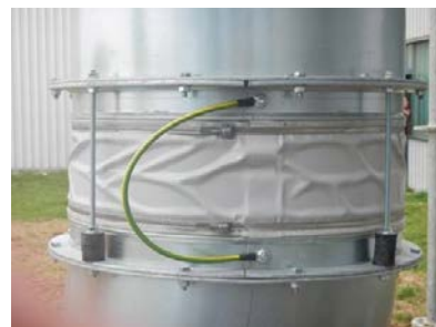
Abb. 31 Kompensator in einer Absauganlage
