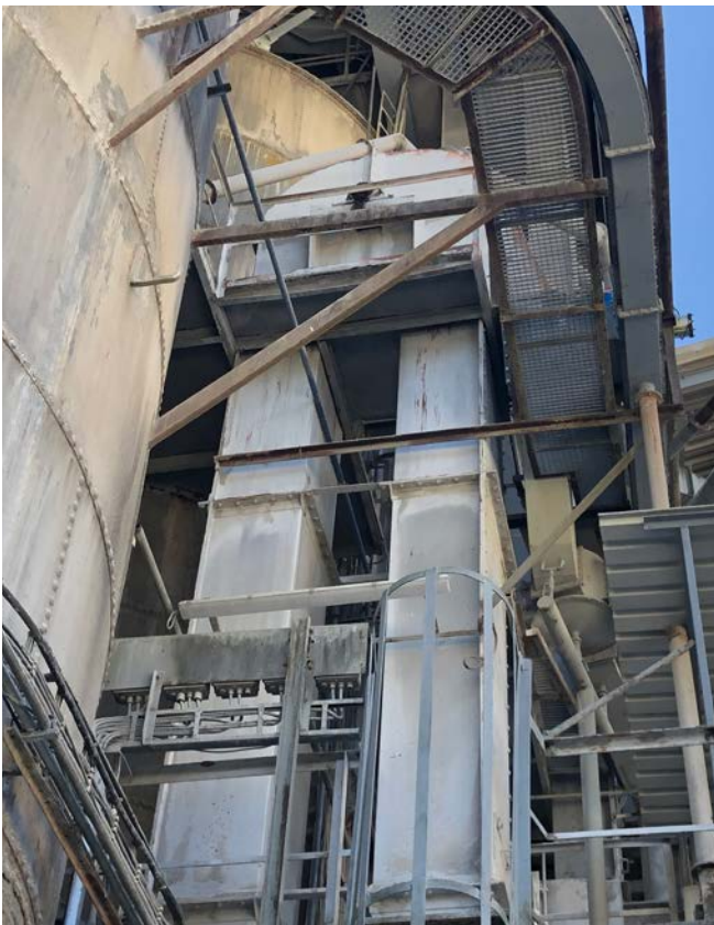
Abb. 34 Becherwerke mit Bühne an den Becherwerksköpfen
